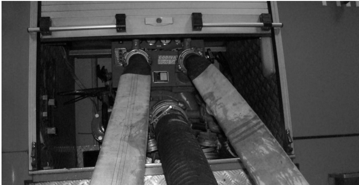
Рисунок 1 - Общий вид насосного отсека с подсоединенными рукавными линиями и частично закрытой шторной дверью
