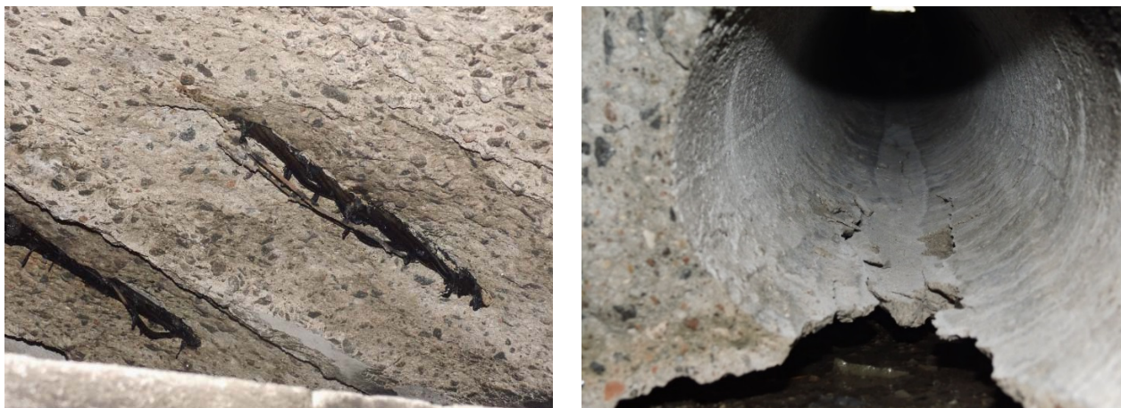
Рисунок 6 – Разрушение защитного слоя бетона экспериментальных образцов
