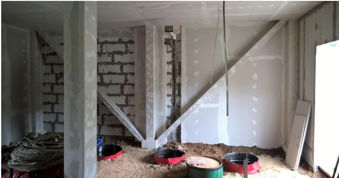
Рисунок 6 – Вид незащищенного участка стены изнутри здания
