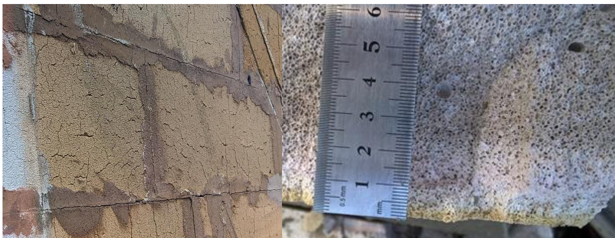
Рисунок 9 – Поверхностная усадка и прогрев незащищенной стены из ячеистобетонных блоков
