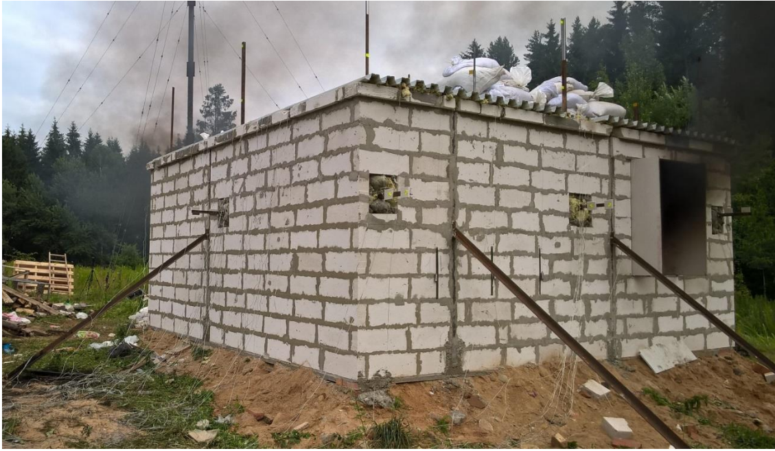
Рисунок 5 – Общий вид фрагмента с построенными стенами из ячеистобетонных блоков в момент начала испытаний
