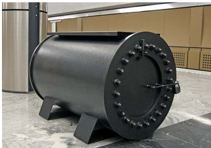
Рисунок 5. – Взрывозащитный контейнер, расположенный на станции Московского метрополитена
